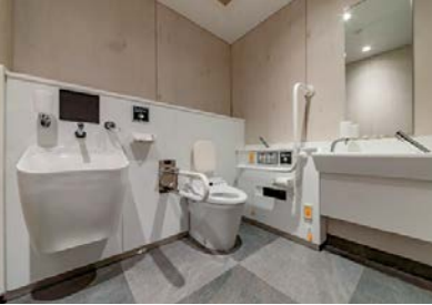
地下1階トイレ
