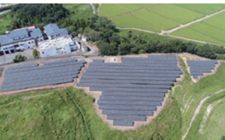
1610kWの発電出力容量を有する 茨城県稲敷市の自社発電所
